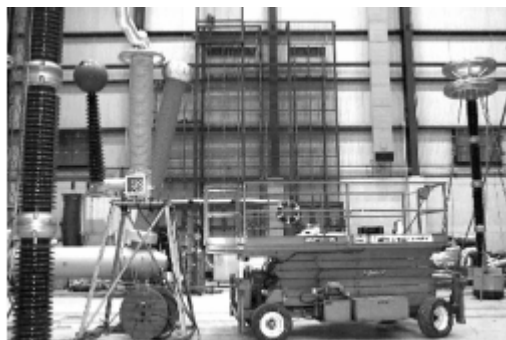
شکل ۷: واگن زمین شده در نزدیکی تجهیزات
